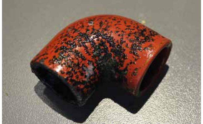
Farbig lackierter Wasser-Auslaufstutzen, eine mechanische Algenentfernung war nicht möglich, weil dadurch die Lackschicht Schaden genommen hätte
